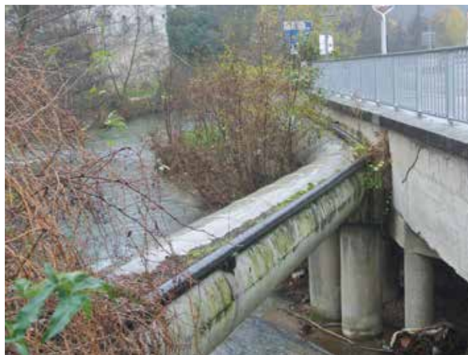
La conduite Bonna qui sillonne le long de la Gère et alimente 9000 abonnés est devenue trop vétuste et doit nécessairement être changée.
